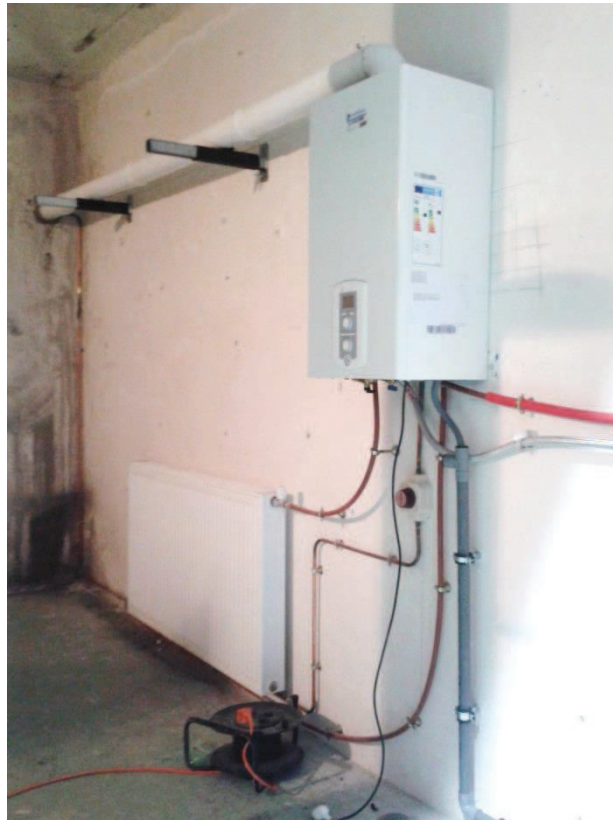
Figure 3 : Chaudière murale et éléments rapportés fixés sur la paroi réceptrice lourde
