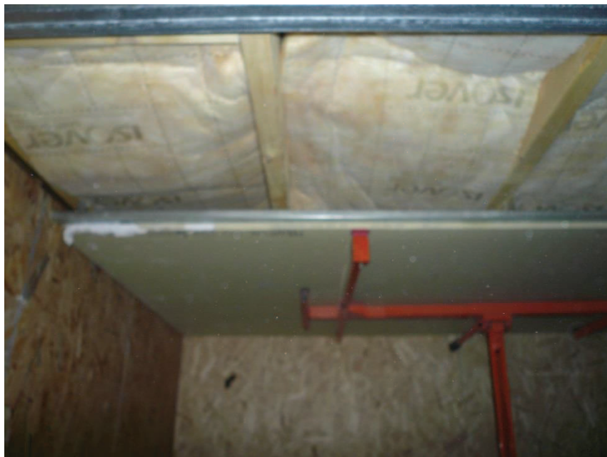
Figure B.7 : Photo de la mise en œuvre du plafond suspendu en plaques de plâtre BA18.
