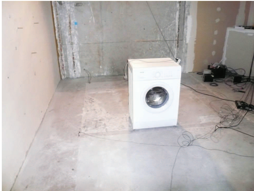
Figure 12 : Machine à laver installée sur le plancher béton de 18 cm d'épaisseur
