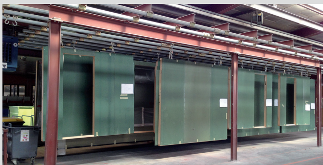
La chaîne verticale de fabrication permet la pose des menuiseries et du bardage.
