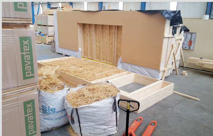
L'isolation en paille est complétée par un panneau de fibre de bois côté extérieur des murs, et par de la laine de verre côté intérieur.
