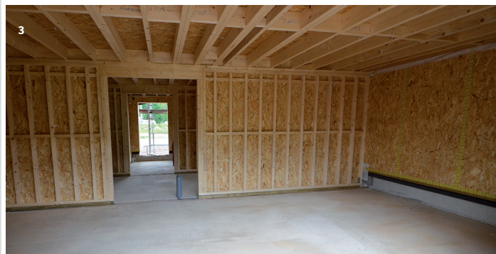
1_Vue avec le car port 2_Préparation en atelier des murs ossature bois (MOB) 3_Vue sur la structure niveau RDC.
