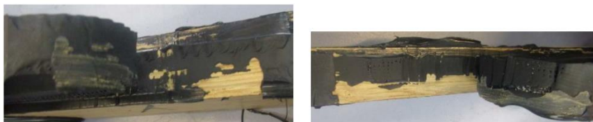
Photo 5 - Rupture avec perte de lasure Fab N°1 – M1 – chêne lasuré – après 7 jours d’immersion sans et avec primaire
