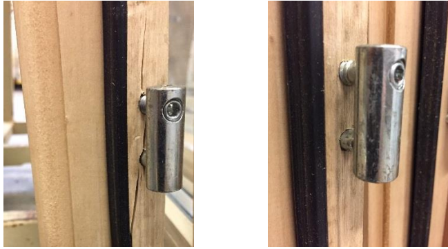
Photo n°6 : rupture et jeu au niveau des fiches basse et intermédiaire montant ouvrant peuplier concept n°1
