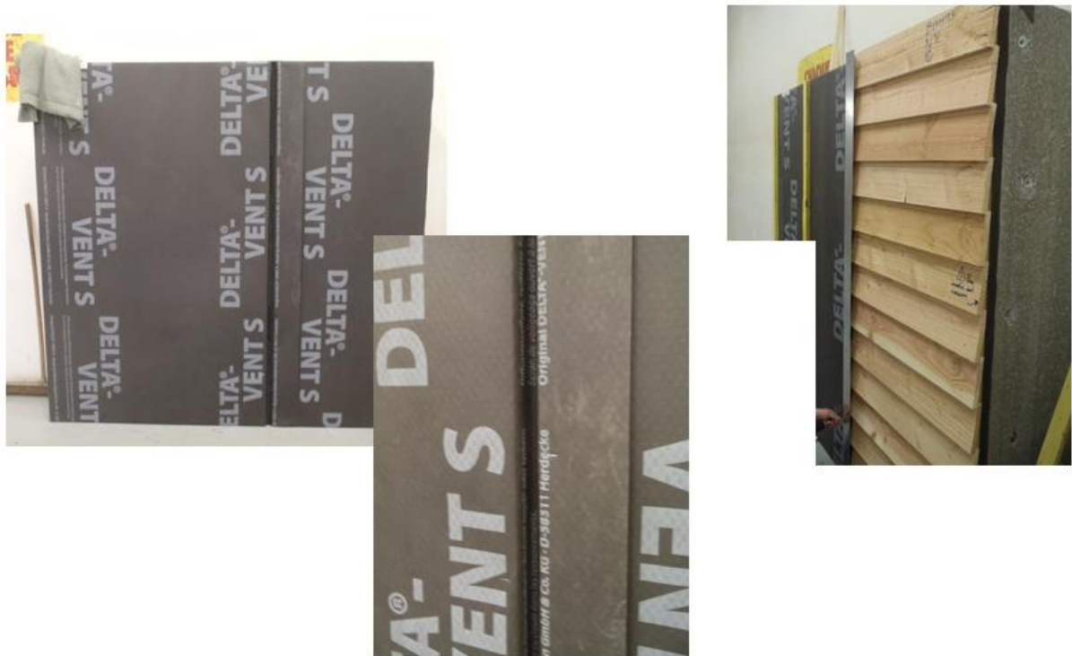
Photo 19 : Montage de la maquette n°6 / Réalisation du traitement de joint de dilatation
