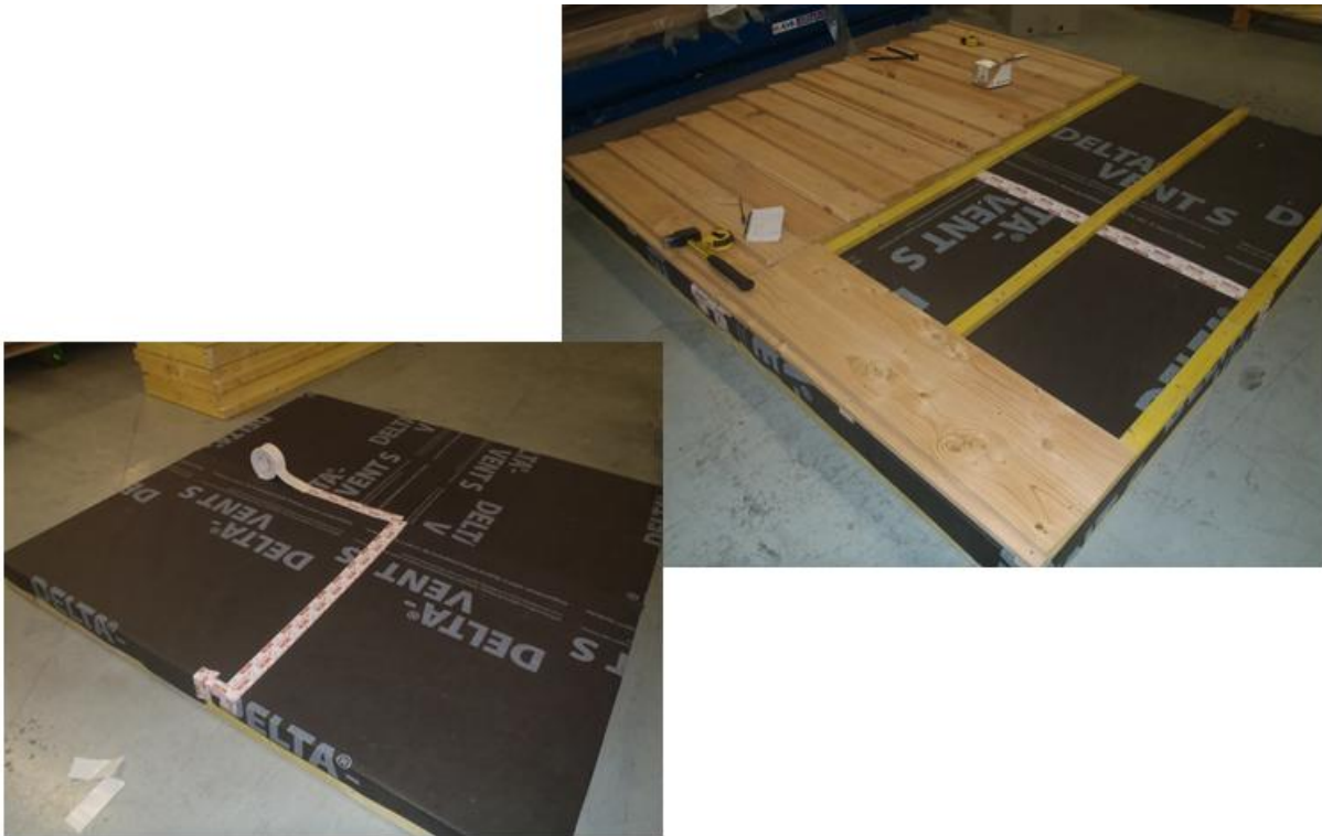
Photo 5 : Montage de la maquette n°1 / Mise en œuvre du pare-pluie et du bardage
